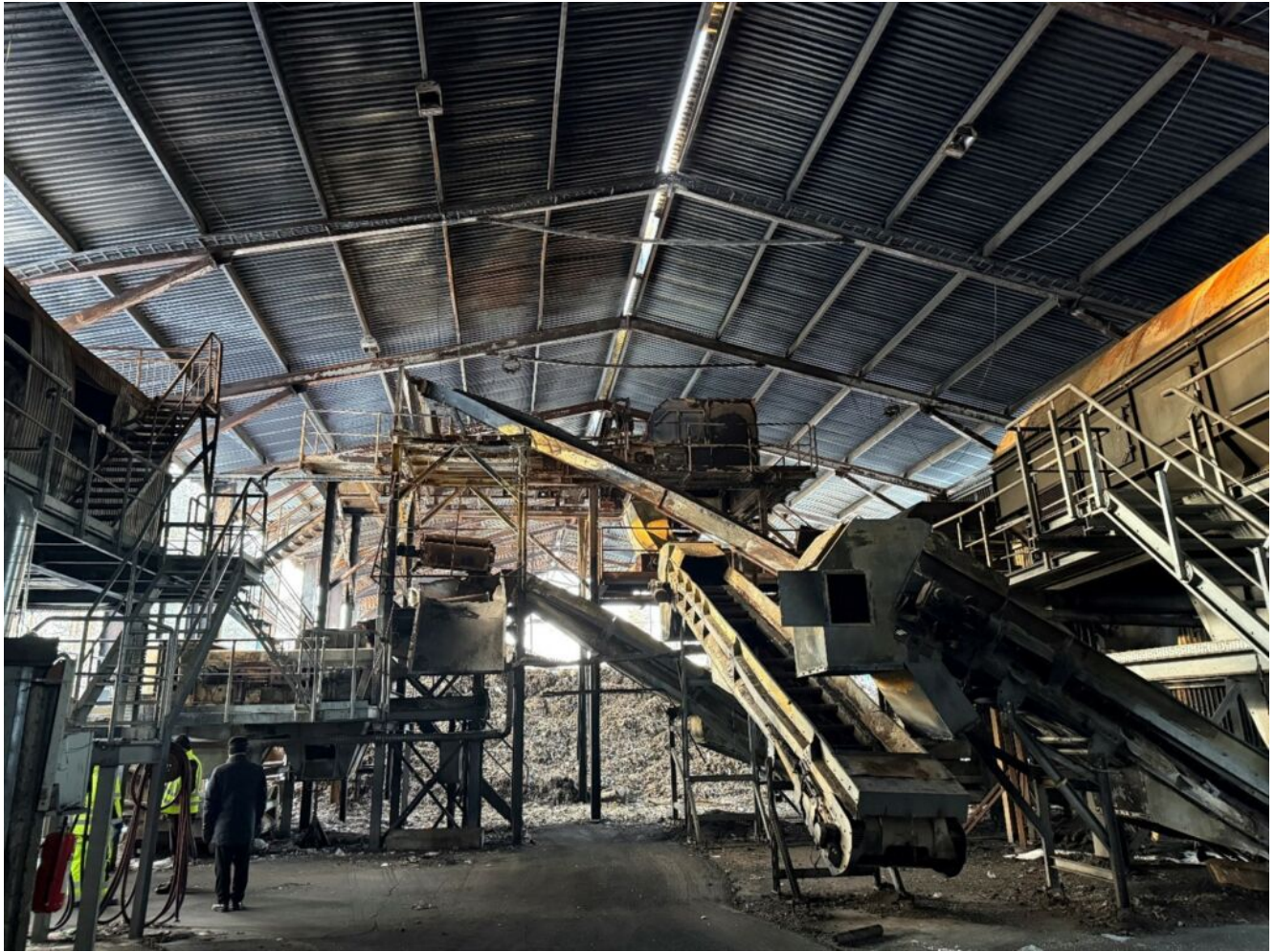
Kuva 1. Halli sisältä palon jälkeen (kuva: Jorma Tuomisto, 2026).
