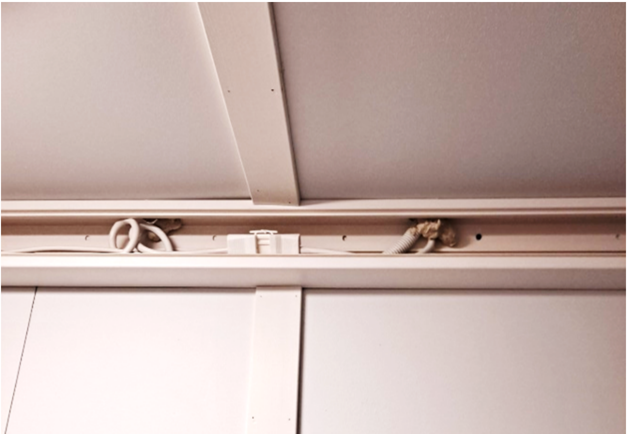
Kuva 2. Moduulien välinen sähkökouru, jossa sähköjohdossa liitin, joka voidaan irrottaa purkamisen yhteydessä (kuva: Veli Autio, 2024).
