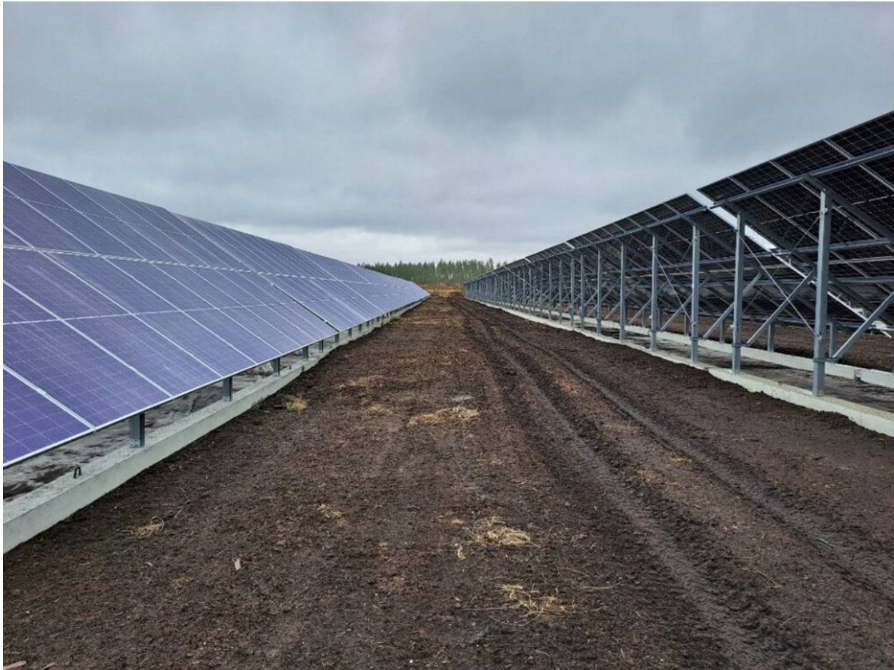
Kuva 2. Suonpohjalla perustettu aurinkovoimala Lapuan Heininevalla (kuva: Kari Laasasenaho).
