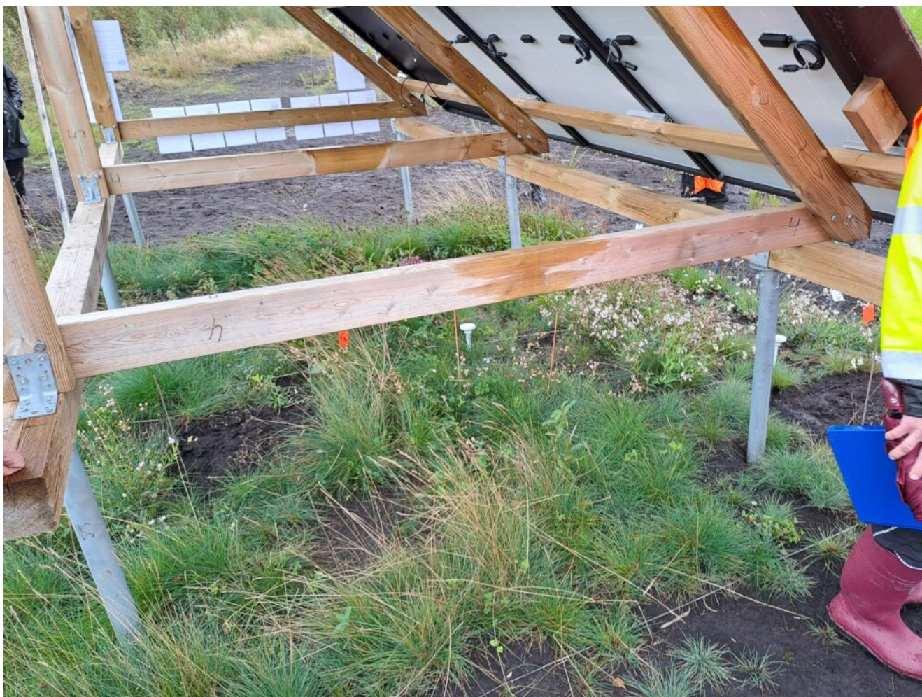
Kuva 2. Kasvillisuuskoeruutuja aurinkopaneelien alla Lantonsuolla (kuva: Kari Laasasenaho).
