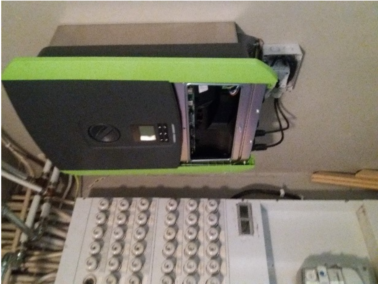
Kuva 2. Sähköpääkeskuksen viereen asennettu Kostal –merkinen invertteri.
