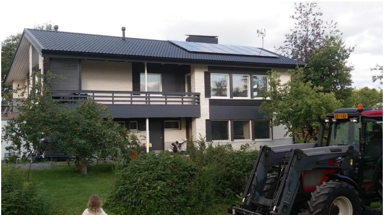
Kuva 10. Omakotitalon julkisivu asennuksen jälkeen. 4,2 kW aurinkosähköjärjestelmä vie vain vähän tilaa omakotitalon katolla ja järjestelmä nostaa kiinteistön arvoa.
