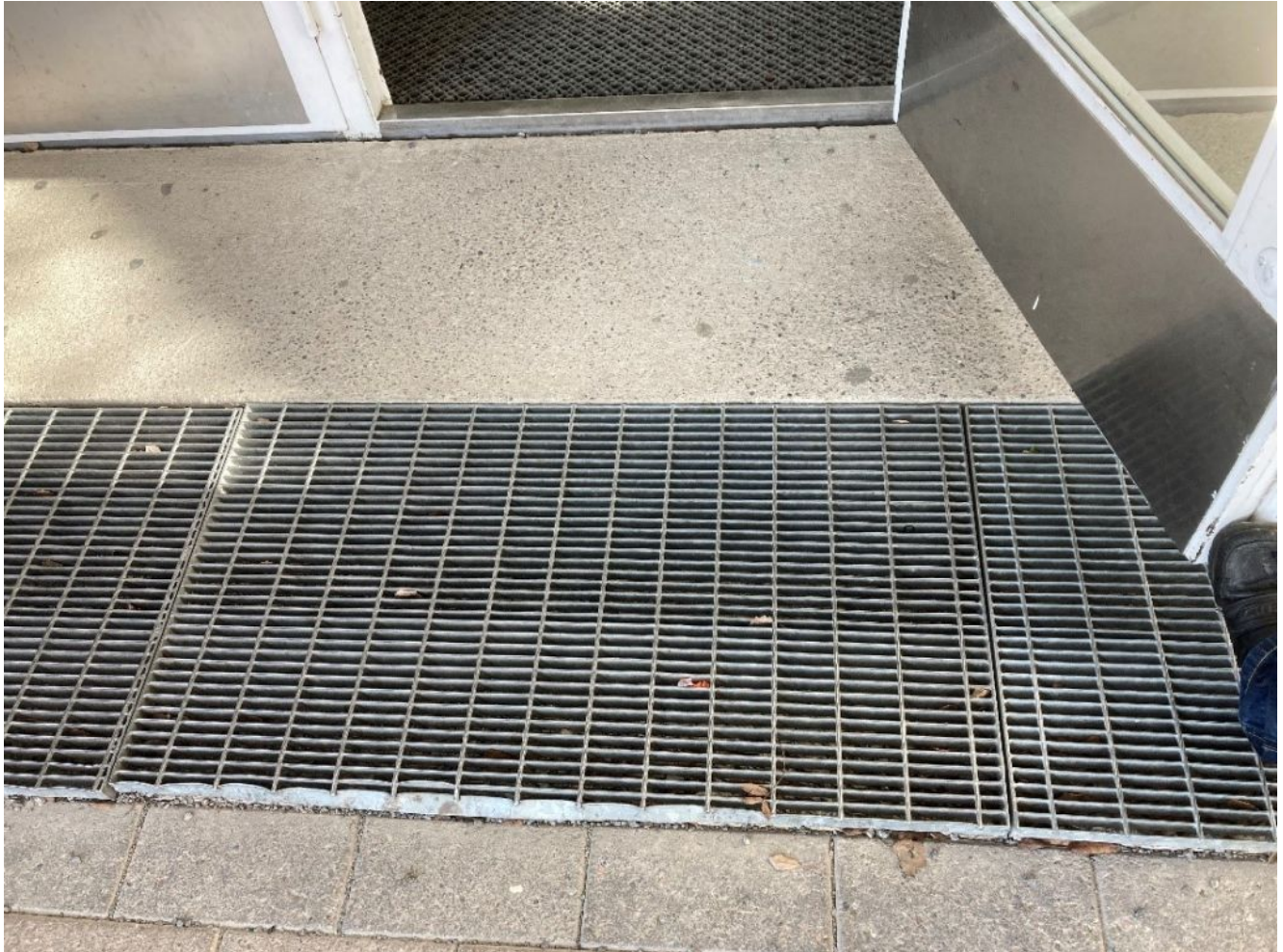
Kuva 2. Pääsisäänkäynnin ongelmana on liian korkeat porrastukset.
